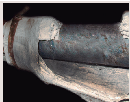
Ilustración 2. Residuos de asbesto de baja densidad o friable
