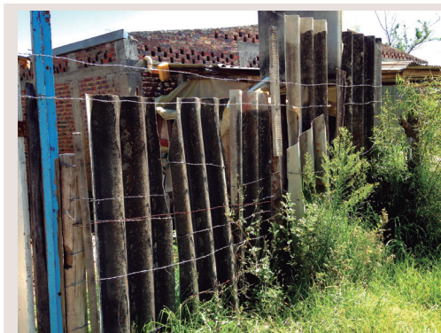
Ilustración 3. Residuos de Asbesto de alta densidad (tejas de fibrocemento con crisotilo)
