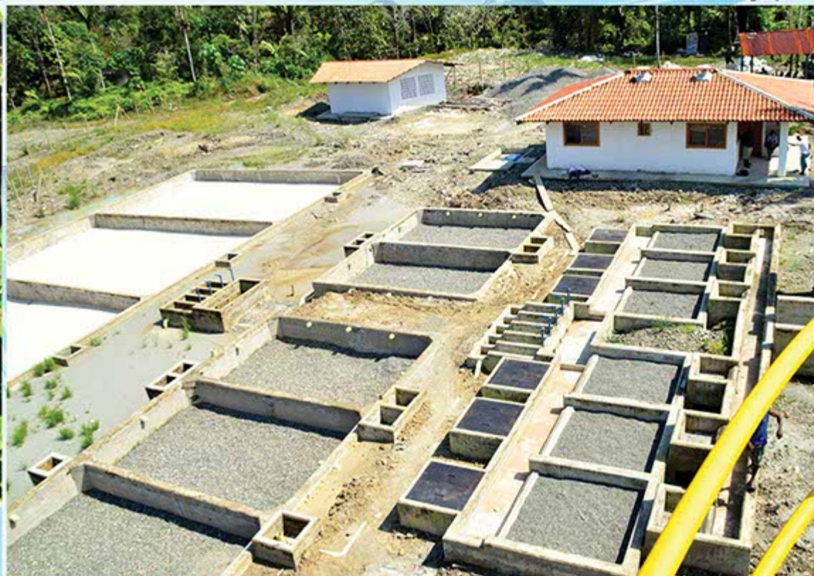
Planta de tratamiento de agua potable
