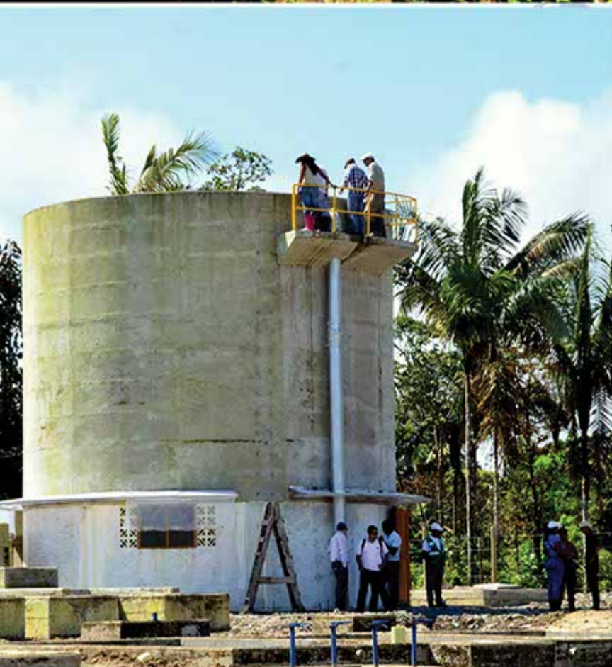
Tanque de recepción de agua en Ladrilleros
