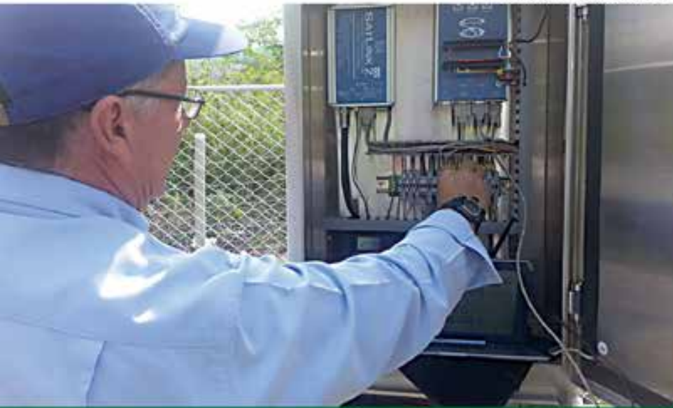
Control de estación automática
